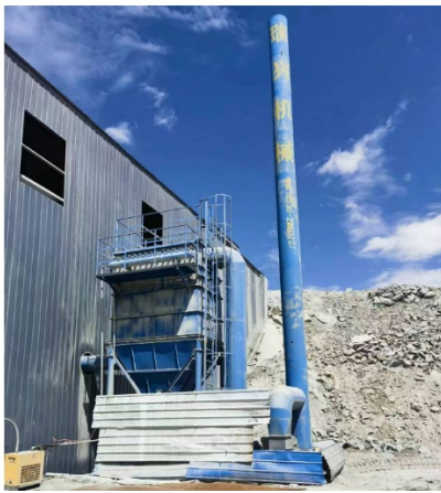
破碎站废气处置
